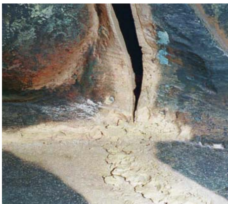
Abb. 21: Riss und Verschweissung (aus BBL 2003)
