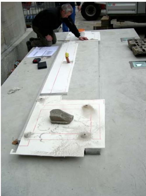
Abb. 114: Fehlkonstruktion des Sockels
