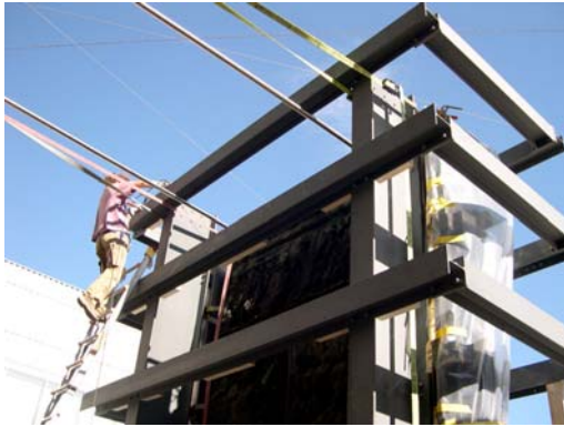
Abb. 90: Sicherung mit Spannset und Stangen
