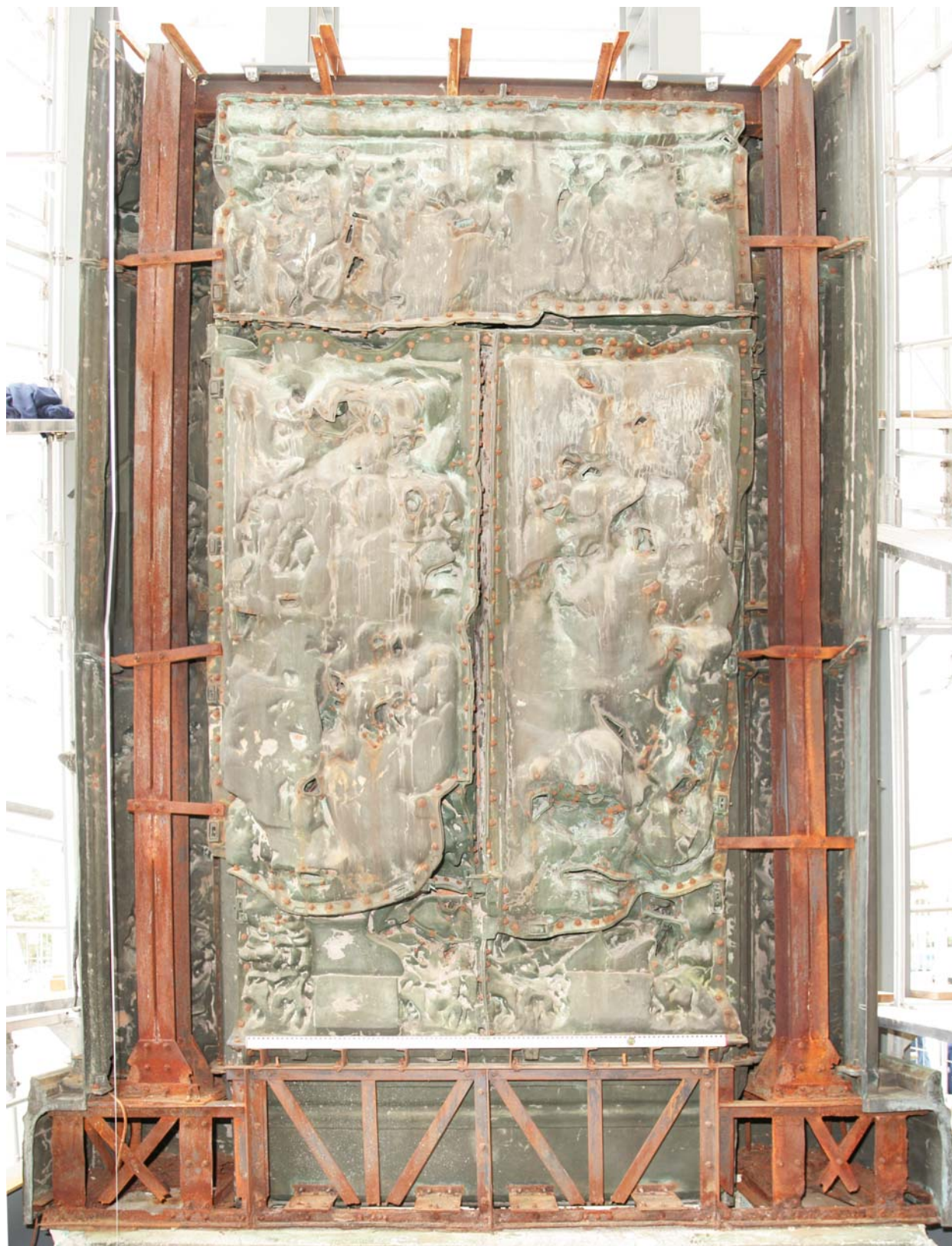
Abb. 65: Graphisch zusammengefügte Gesamtansicht der Rückseite des Höllentores vor der Restaurierung. Stark korrodierte, originale Stützkonstruktion und Verschraubung aus Eisen. Gefährdung der Tragfähigkeit der Elemente im unteren Bereich aufgrund teilweise totaler Durchrostung.
