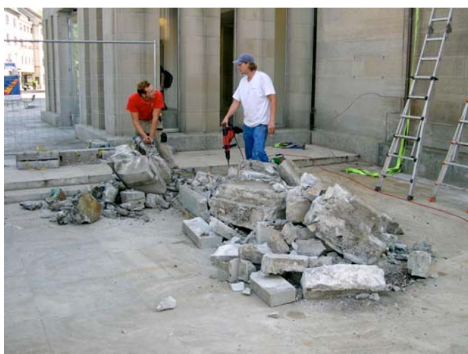
Abb. 101: Zerstörung des Sockels
