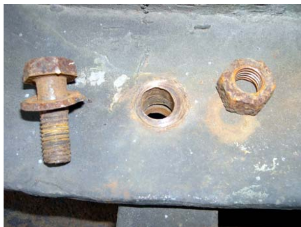
Abb. 64: Korrosionsbild an den Schrauben
