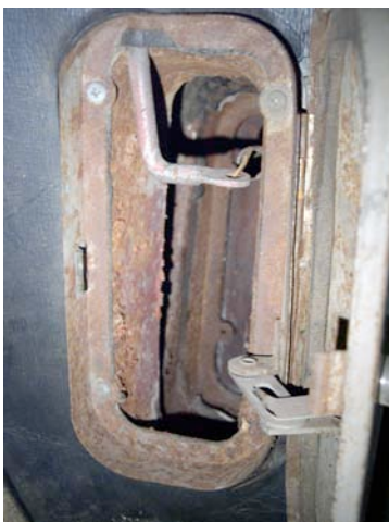
Abb.79: Rostbildung im Innern des Lüftungsschachts
