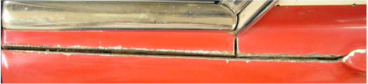
Abb.286: Linke Fuge nach Entfernung der Korrosion mit dem Elektroschleifer
