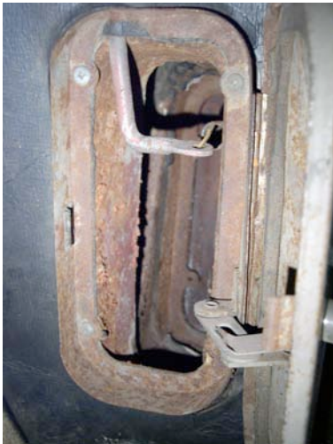
Abb.114: Rostbildung im Innern des Lüftungsschachts
