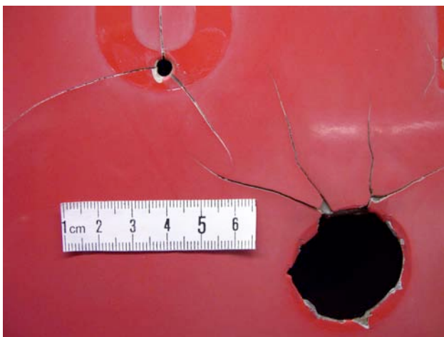
Abb.207: Rissbildung und Loslösung vom Substrat
